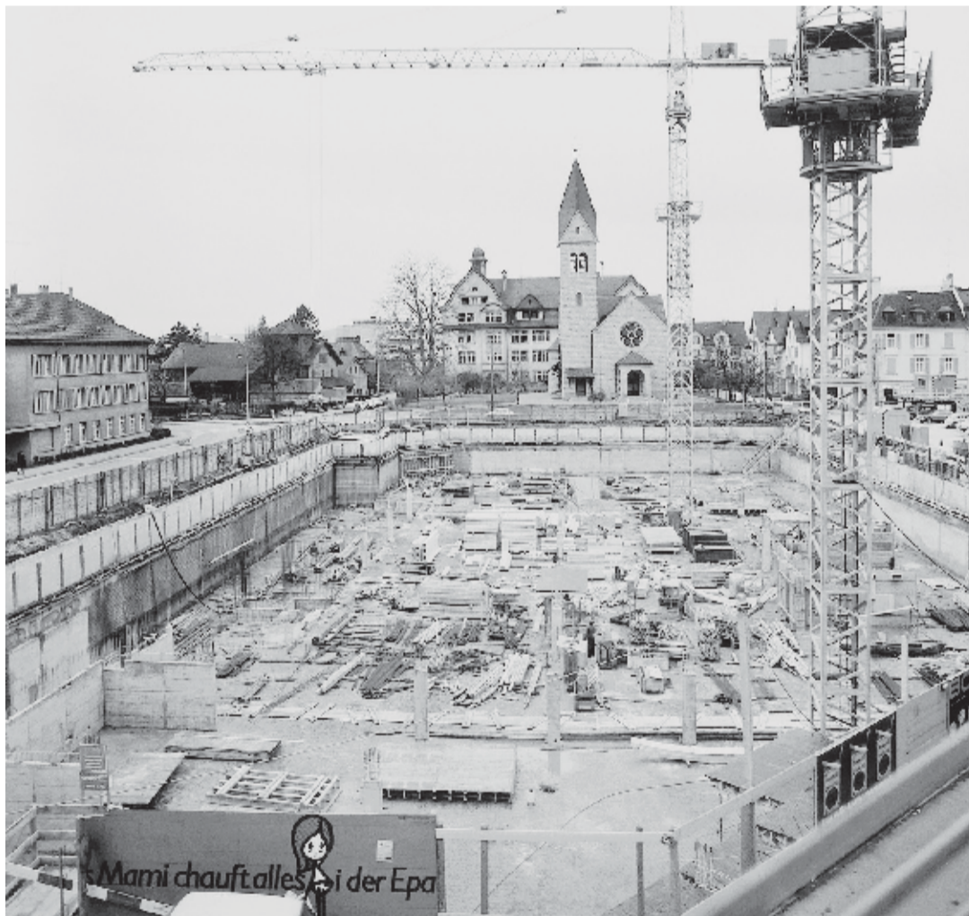
Die Unternehmung baute nicht nur Bahnhöfe, sondern auch für Zug prägende Gebäude. Im Bild das Warenhaus EPA am Bundesplatz (heute Coop City). Bild: Archiv Landis Bau
